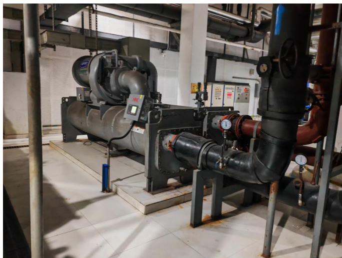
离心式冷水机组现状照片
