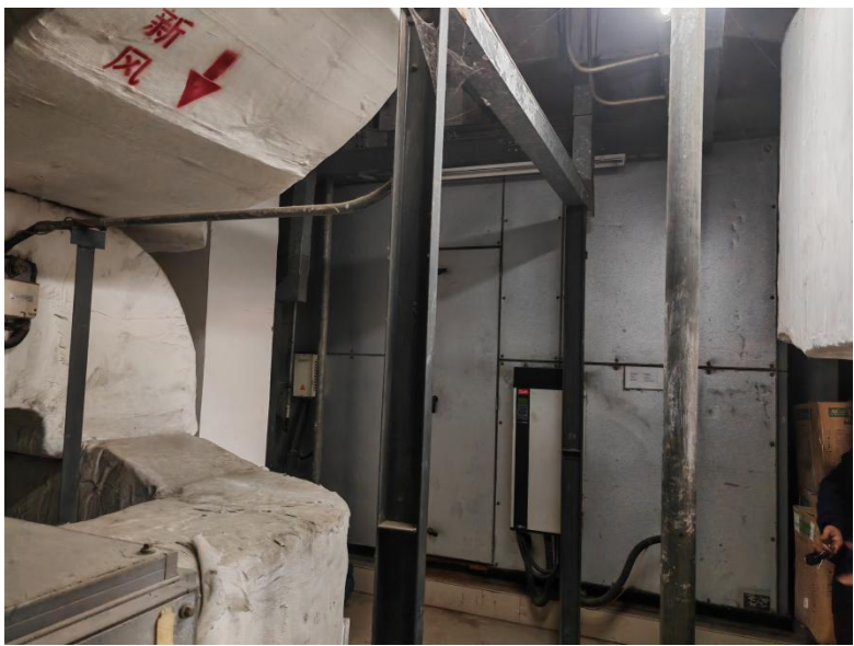
空气处理机组现场照片
